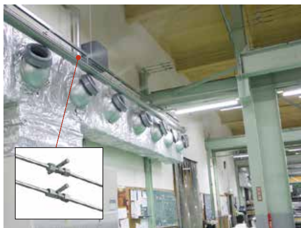
空調の吹き出し空気に加湿を乗せて、室内に届けることで、加湿用ファンを削減。加湿水の生地への付着を防止します。
